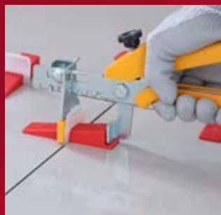
Sistema de Nivelación
